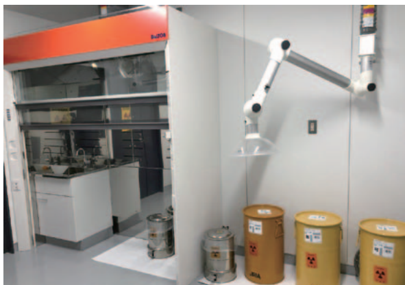
写真11 保管廃棄作業室のウォークインドラフトおよび局所排気設備
