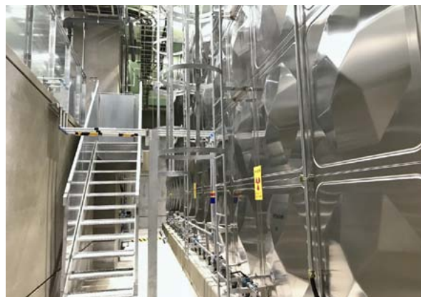
写真14 排水設備の貯留希釈槽
