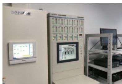
写真2 中央監視・制御装置
