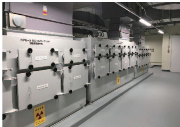
写真13 排気設備のフィルターユニットおよび通路
